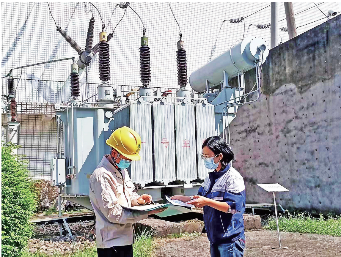
国网重庆市北供电公司工作人员在企业检查安全工作
