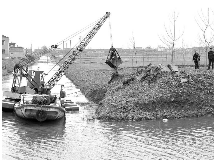
大冈镇把河道疏浚工作列为改善群众生活环境、提高防汛抗旱能力的实事工程。今年以来,该镇投入200多万元,组织15台(套)疏浚机械,对镇区40条河道进行疏浚,疏浚淤积土方达70多万方,并落实河段管护责任。图为该镇冈中圩区河道疏浚清理现场。王金祥 摄
