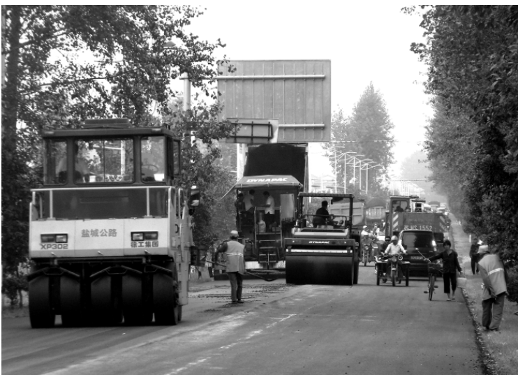
近年来,盐城市公路处始终将巩固文明样板路创建成果当着公路养护的重中之重来抓,努力为广大公众营造“畅、洁、绿、美、安、优”的良好通行环境。图为该处9月份在S233线K66—K74处摊铺沥青碎石料施工现场。(仇金留 江朝华 摄)
