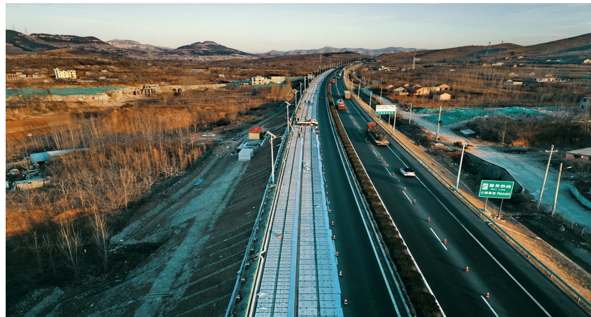
2017年12月13日,济南绕城高速公路南段,施工人员正在铺设光伏路面,地面上一个个白色方格下方就是太阳能电池。预计今年12月底正式竣工的济南绕城高速,将成为全球首条承载光伏路面研发与铺设的高速公路。光伏高速路面分三层:表面与车辆行人接触的保护层用的是“透明混凝土”;中间层铺设的是光伏电池发电组件可以利用阳光发电;底层则是隔绝下方湿气的绝缘层。目前这条长度为2公里的光伏高速公路施工已经进入尾声,预计年底前后就能竣工通车,未来将提供源源不断的绿色电力。
