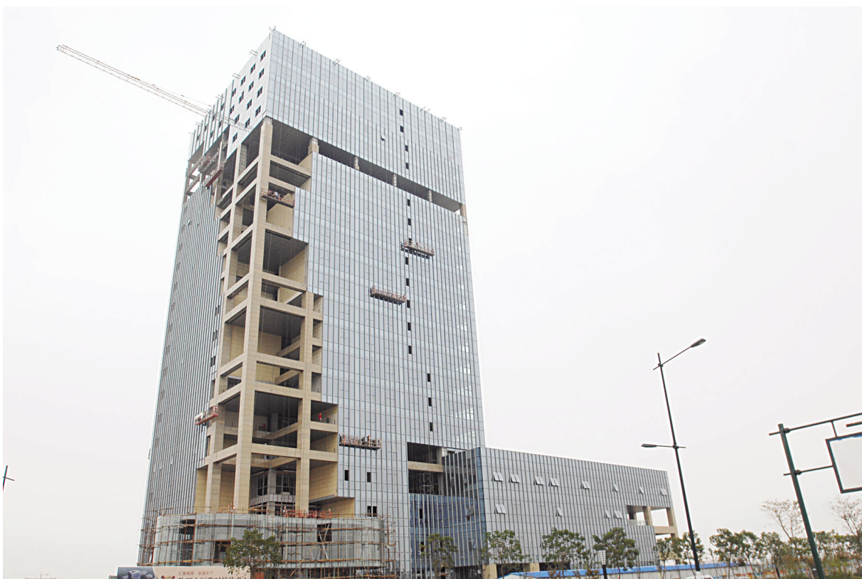
高87米、总建筑面积3.8万平方米的盐都物联大厦,作为物流产业园的标志性建筑,自去年9月启动建设以来,施工单位抢抓时序、保质保量。目前,主体已竣工,外装进入收尾阶段,内装1至6层正紧张施工中。预计11月底全面建成并交付使用,投入运营后将吸纳企业超20家。 本报记者 陈雁程 摄
