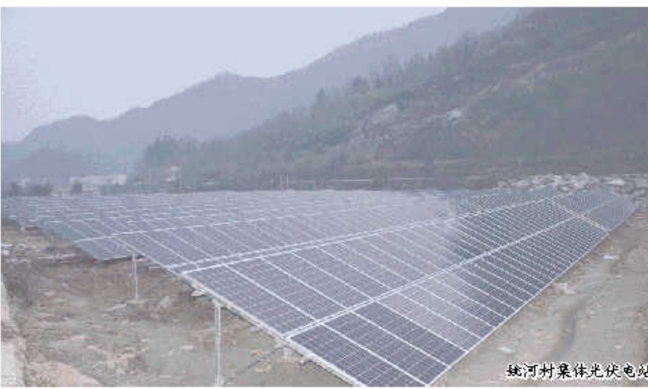
姚河村集体光伏电站。
