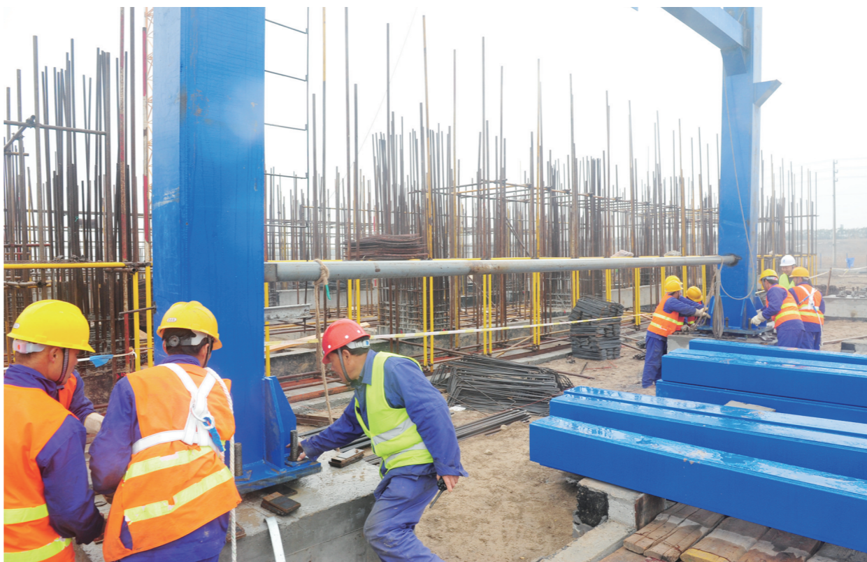
4月12日,大丰英茂糖业建设现场,工人们正在紧张施工。据悉,该项目主体厂房框架已基本完成,预计下半年进行设备安装。建成投产后,可全年加工原糖102.4万吨,年产精制糖、优级白砂糖100万吨,副产品糖蜜3.7万吨,年产值达50亿元。
