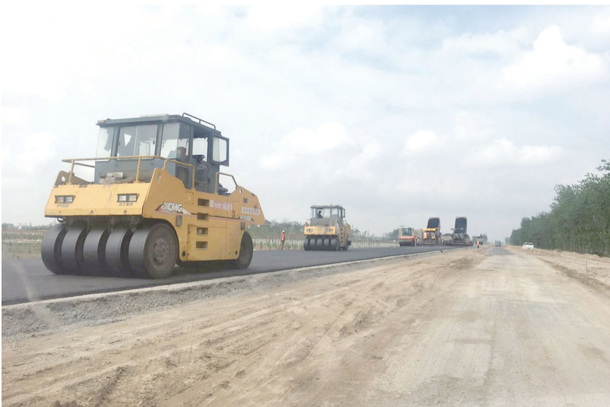
近日,记者在省道351施工现场看到,一台台大型机械正紧张作业。据介绍,351省道在我区境内全长44公里,途经白驹、小海、万盈、草庙等镇。目前,陈李线以东已全部通车,陈李线至沿海高速段将在今年年底前建成通车。 邱鹏 摄
