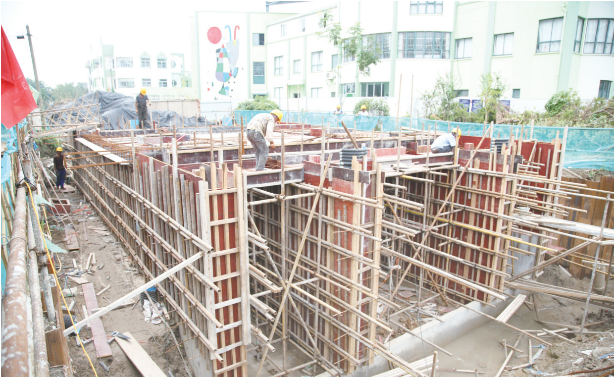
9月4日,实小幼儿园东沟整治工程项目现场,施工队在紧张施工。本次整治范围长1.274公里,主要采取清淤、驳岸、截污、绿化、活水等措施,美化河道,改善水质,计划12月底竣工。万成 摄
