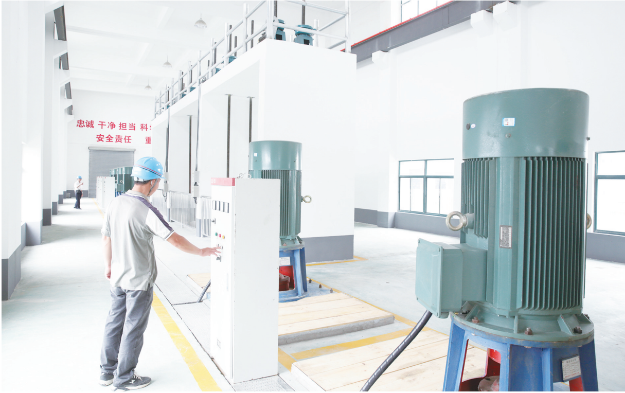
6月29日,区域防北站工作人员在启用排涝设备。连日来,该站立足防大汛、抢大险、救大灾,制定应急预案,备足防汛物资,做好周密准备,确保关键时刻拉得出、打得响、战得胜,确保安全度汛、平稳度汛。万成 摄
