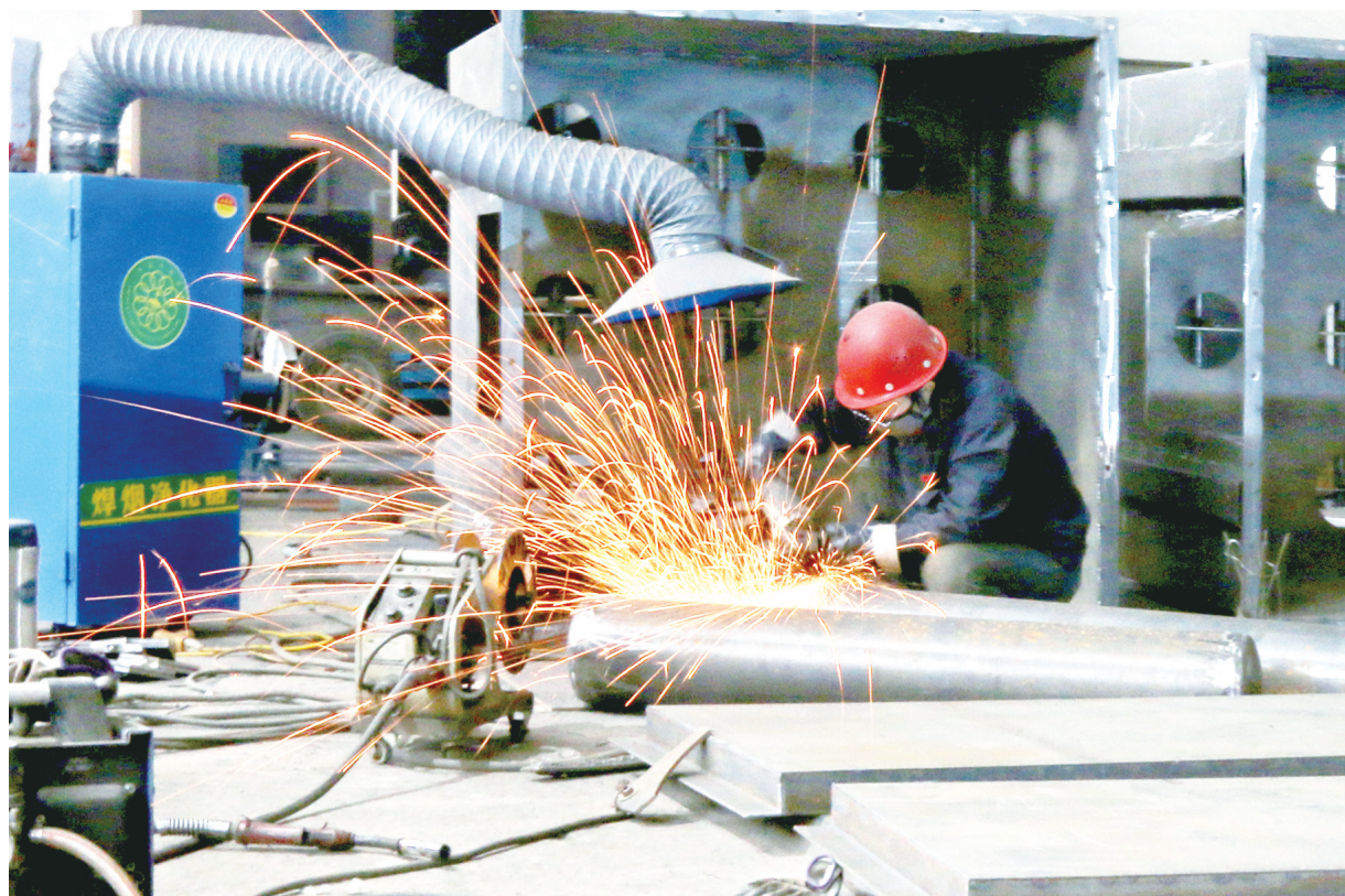
近日,位于西团镇的荣盛除锈设备有限公司生产车间内,工人正在进行焊接作业,到处呈现出一派繁忙景象。目前,该公司正加班加点,大干四季度,奋力冲刺全年目标任务。陈荣 摄
