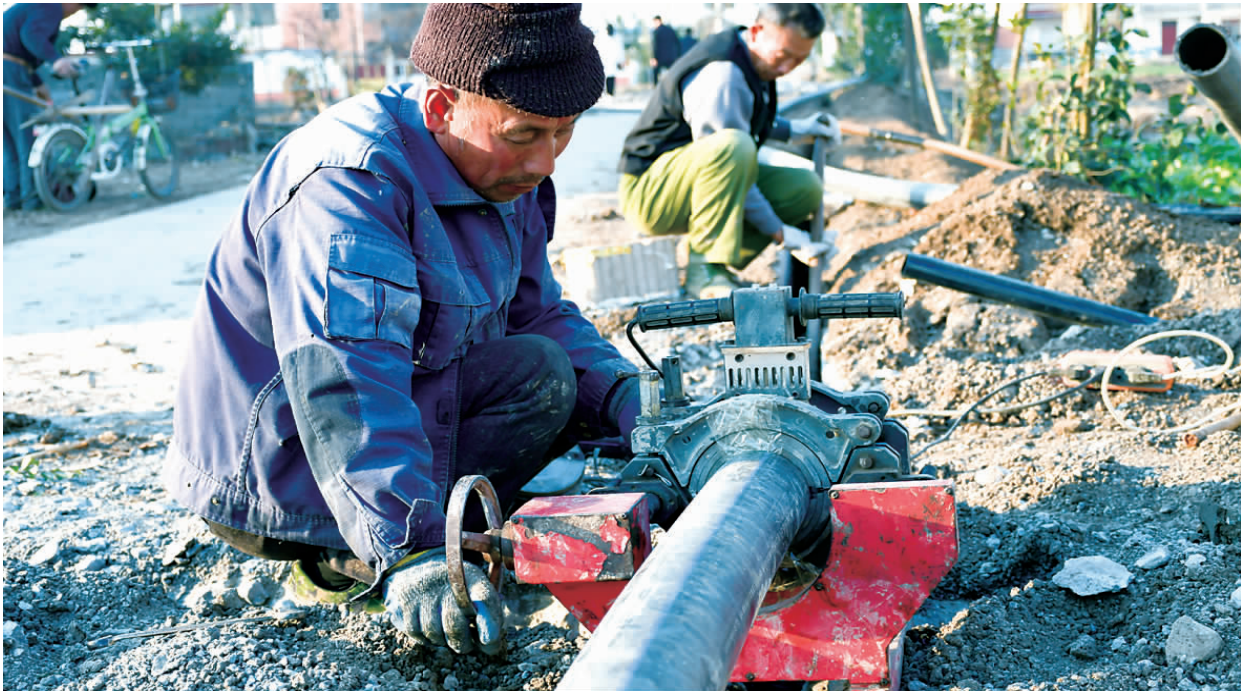
为了保证村民长期持续稳定饮用优质自来水，降低农村管网多年来老化破损的供水漏损率，县水务集团抢时间，抓进度，全面实施农村三级管网改造工程。图为施工人员正在堆沟港镇许圩村进行三级管网改造。
