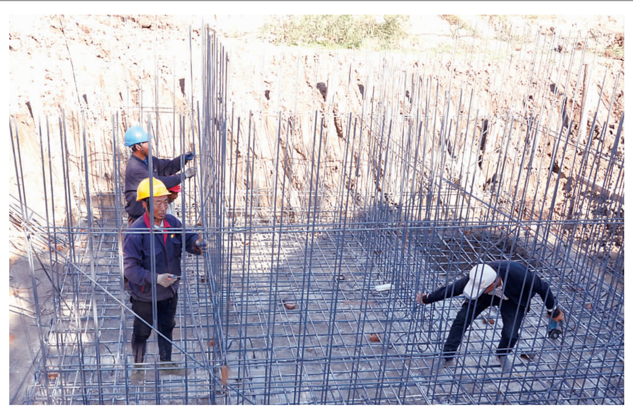
10月24日上午,施工人员在田楼镇浦二庄村污水处理项目施工现场紧张忙碌。为全面推进农村生活污水治理,持续改善农村人居环境,田楼镇根据《2019年全省农村生活污水治理专项工作推进方案》,在已经建有16个村级污水处理站的情况下,今年将新建4个建制村污水处理设施,全面提高农村生活污水管控机制,提高农村生活污水管控水平。(王华 陈新 文早 摄)
