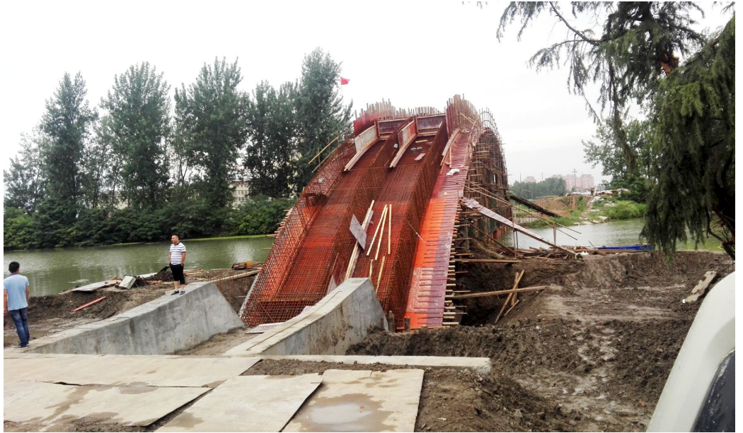
韩俊桥是连通萧湖和里运河的一座步行桥,计划总投资1200万元,由江苏镇淮建设集团公司于2016年10月开工建设,预计今年年底竣工。建成后的韩俊桥将如同一条靓丽的彩虹横跨里运河两岸,成为里运河上的一道风景。 杨文龙 摄
