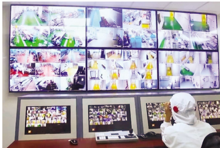
中央厨房项目中控室
