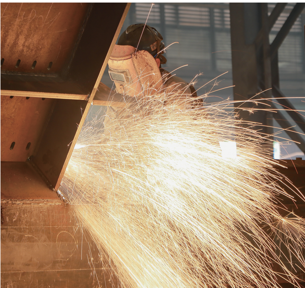
在中建钢构江苏有限公司,工人们正在高温下进行焊接作业。
