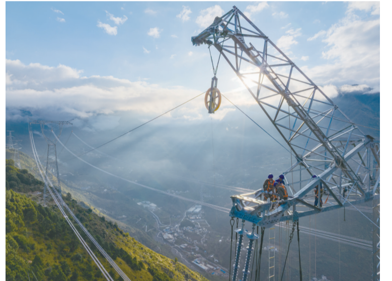
2024年10月15日，在四川省甘孜藏族自治州泸定县，施工人员在川渝1000千伏特高压交流工程进行收紧导线作业。
