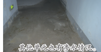
地下通道渗水。
