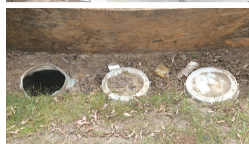
现场的过滤系统。
