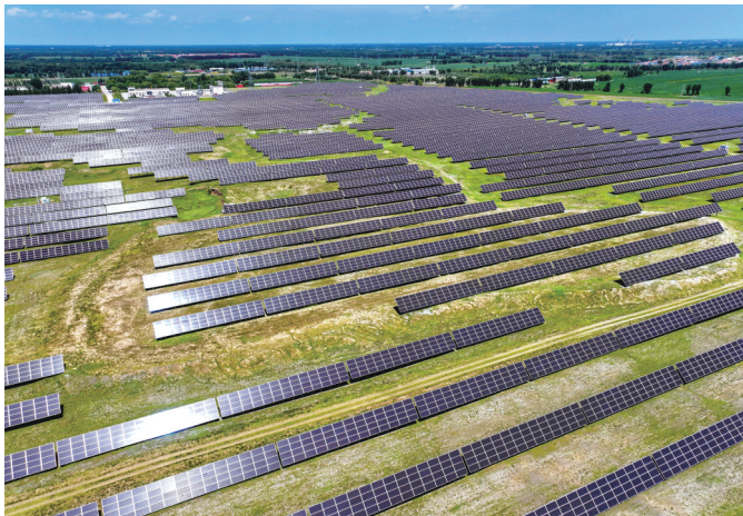
2024年7月19日拍摄的内蒙古通辽发电总厂光伏电站(无人机照片)。
