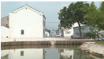
河边护栏缺失,存在安全隐患。
