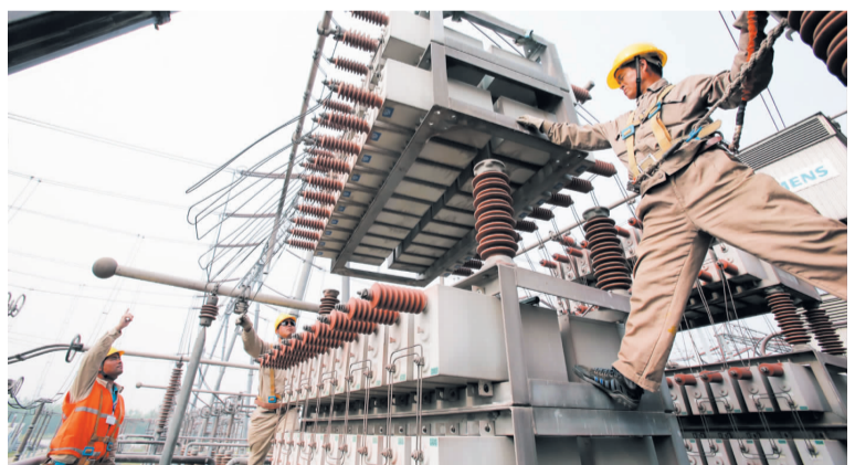
近日,江苏电力公司组织力量对所辖的48座500千伏超高压变电站进行检修维护,全面提高设备健康水平,确保电网在即将到来的迎峰度夏期间安全稳定运行。 郑炳臣 王旭光 摄
