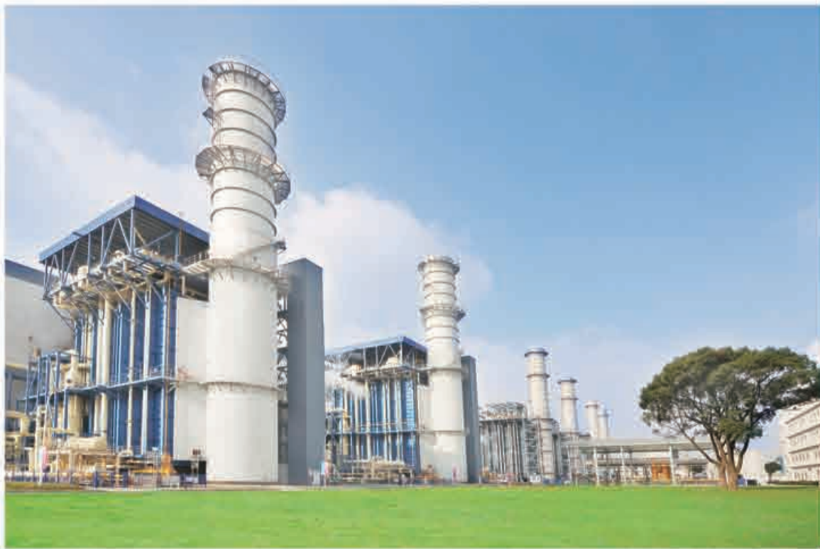
威电公司六台燃气机组全景
