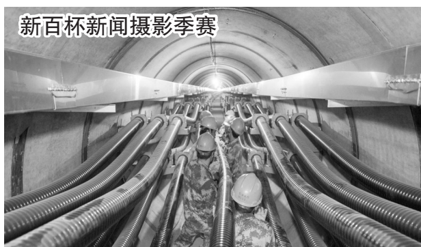
近年来,国家电网无锡供电公司实施“电缆入地”工程,将纵横交错的架空线改为地下电缆,美化市容市貌,图为电力工人在16米深的地下电缆隧道中铺设电缆。 潘正光 摄
