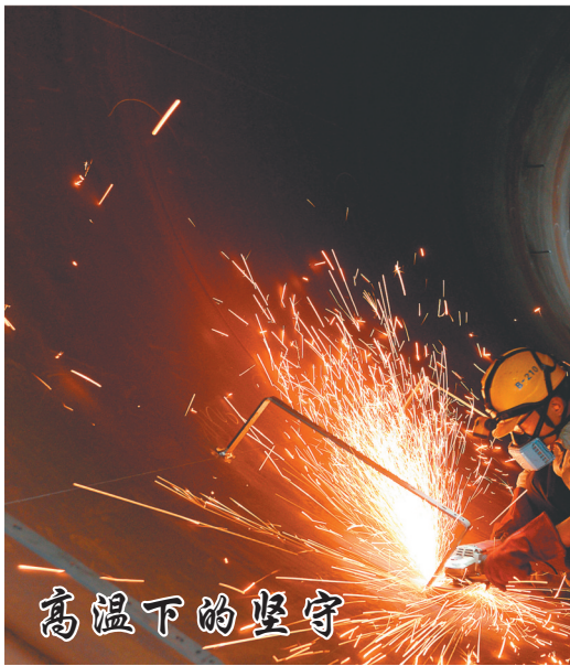
图1 中国电信江苏淮安分公司智慧家庭工程师冒高温酷暑在为客户安装宽带。 图2 市政工人奋战在连云港市赣榆区石桥镇境内的石林公路浇筑沥青、修路。 图3 中建安装集团五洲工程装备有限公司工人正在生产加工风力发电塔筒设备。
