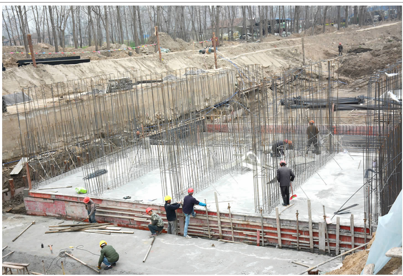
城北排涝站 建设工程是县委、县政府2017年为民办事实项目，该工程建成后有效改善区域排涝能力。目前，该站身底板砼已浇筑完成，其它工程正有序进行，预计年底前全部完成。（姜浩 摄）
