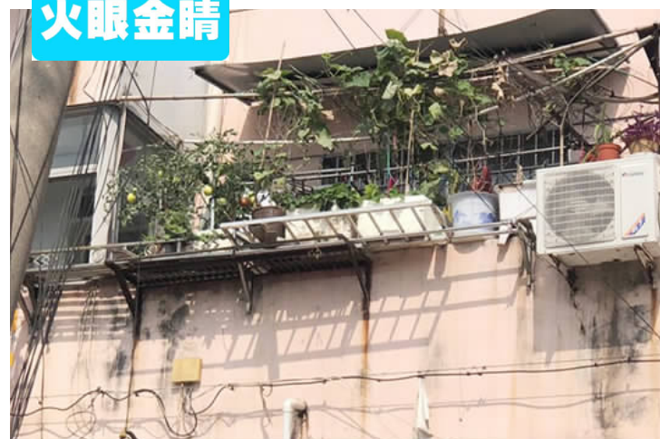
金城南路,郑梁梅小学对面小区住户在晾衣架、空调挂机上边栽植盆栽,风雨天很容易坠落,存在安全隐患。
