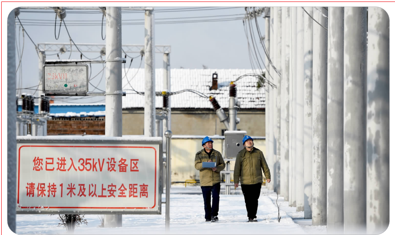
县供电公司组织人员对全县变电站、综合变压器、10千伏以上线路开展雪后特巡,保障设备安全稳定运行。图为该公司变电运维人员在110千伏朱码变电站内巡视。(丰其生 陈浩 摄)
