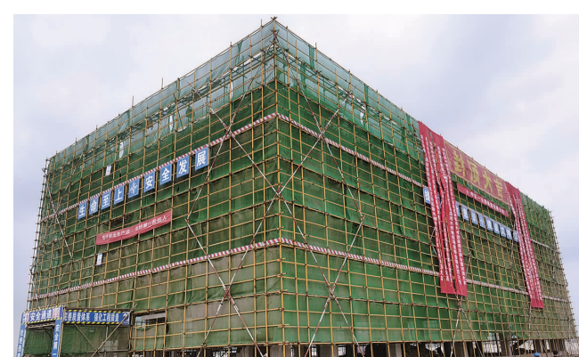
昨日下午,随着最后一方混凝土浇筑的完成,灌云县燕尾港进口木材检验检疫处理区项目综合楼成功封顶,标志着项目建设取得了阶段性突破。据悉,该项目总投资约3亿元,主要建设年熏蒸200万立方米进口原木的处理场地。(李士静 马兆兴)
