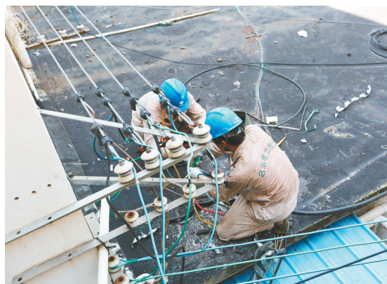
高温抢修烧坏进户电缆
