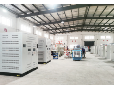
爱明林脉电气项目完成投资1亿元,主要生产箱式变压器及高低压成套设备,招引单位为宿城区支口街道
