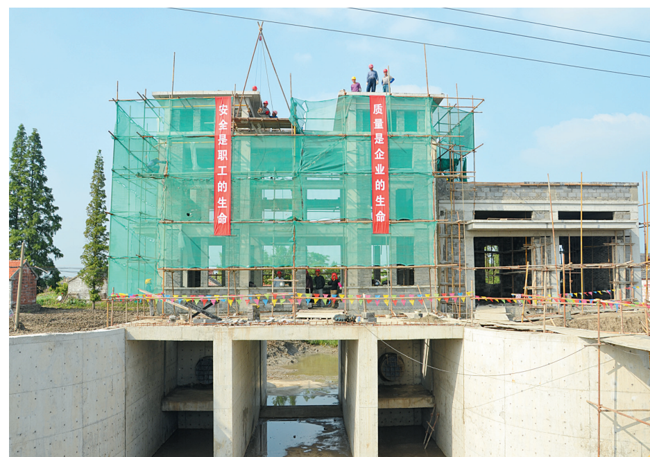
位于龙冈镇年余圩区储巷生产河与盐宝河交界处的储巷闸站工程,是2016年度中央财政小型农田水利重点县项目之一,总投资245万元,于今年2月份开工建设,目前主体工程基本完成,正在进行机泵安装,力争在汛前投入使用。据悉,该工程建成后,排涝流量可达每秒4立方米。图为该工程施工现场。 本报记者 卓玲 摄
