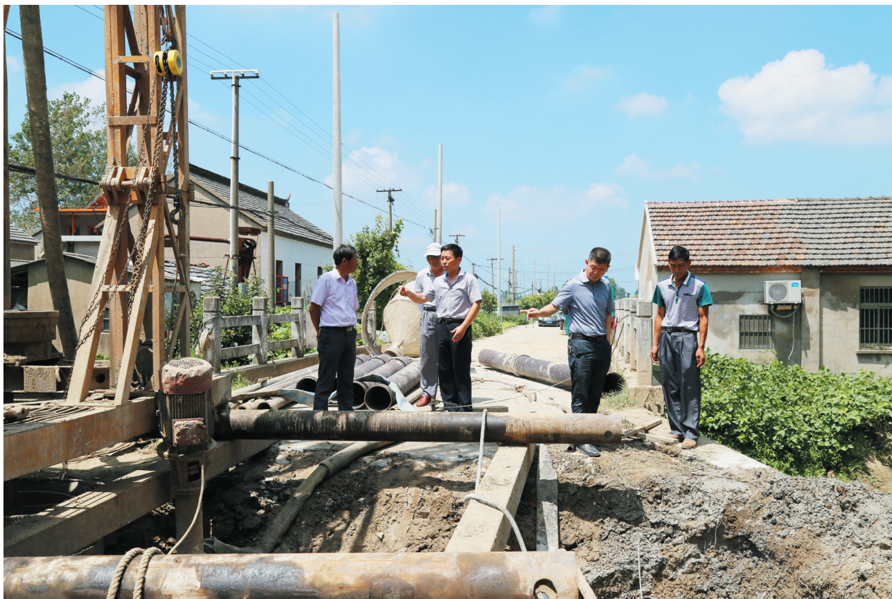
连日来,区农村公路纪检监察巡查组对全区今年计划建设的149公里农村公路、131座桥梁提档升级情况进行巡查。通过听取在建项目情况汇报、查阅相关台账和察看施工现场等方式,共巡查出6项不规范问题,并现场作出整改要求。图为巡查人员正在巡查富镇农村公路桥梁建设现场。 王银忠 摄
