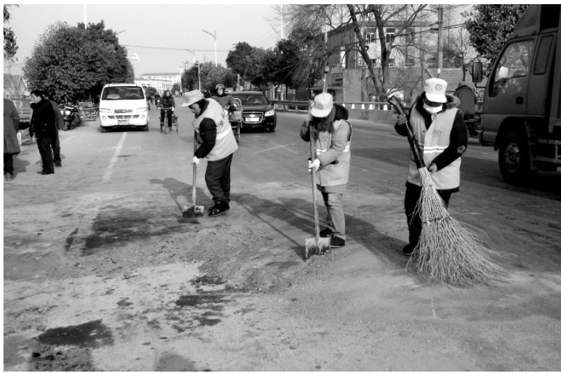
1月4日,在204国道伍佑镇境内发生一起车祸,一辆货车与拖拉机迎面相撞,导致防护栏被撞坏,碎玻璃、机油等污染路面约500平方米。区公路站闻讯后,立即装运防滑石料,组织路政、养护人员进行现场抢险,经过近两个小时的奋战,该段交通已恢复畅通。图为该站养护人员在现场抢险。 仇金留 孙正春 摄
