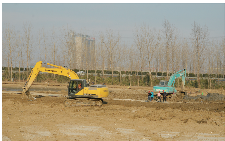
大马沟生态公园西拓工程纬七路至智慧路段,面积达296亩,工程预算3000万元。该工程以“防护、生态、休闲”为功能定位,设立“枫林大道”“樱花烂漫”“杉林物语”“松间棠影”“荷塘月色”等植物主题分区,突出植物特色,串联水系,着力打造居民休闲、活动好场所。目前,该工程已开工建设,预计3月底竣工。图为该工程施工现场。 本报记者 卓玲 摄
