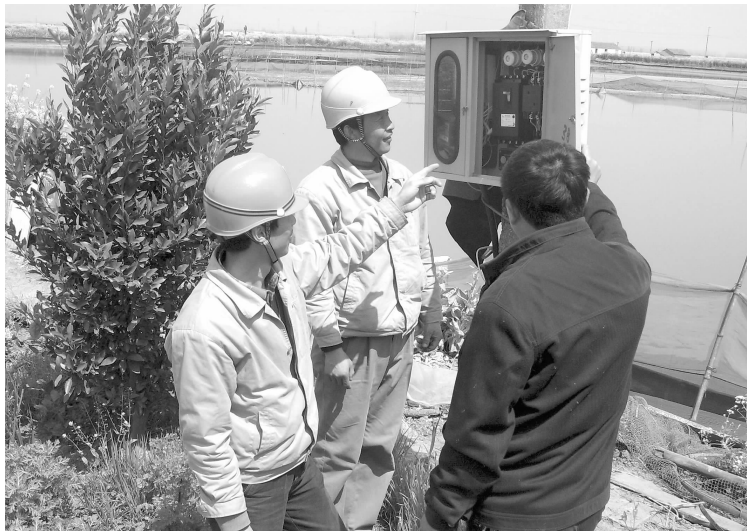
盐都供电公司主动将服务窗口前移,积极组织人员深入养殖塘口,免费帮助养殖户检修投料机电动机,并宣传安全用电知识。图为4月5日上午,该公司的农电员工正在检修抽水电动机。红旗 祁贵/摄
